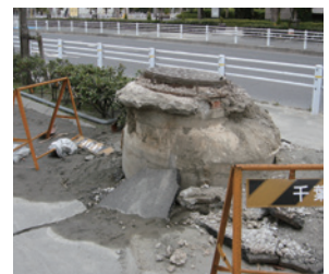
浦安市の液状化被害
