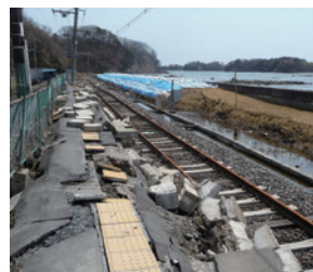
東日本大震災による鉄道被害
